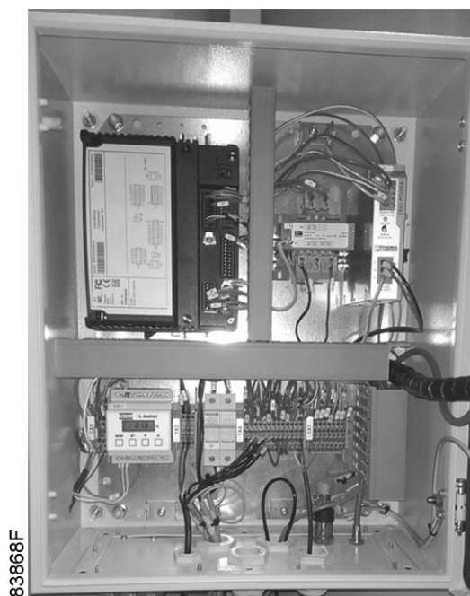
Внутри шкафа управления
