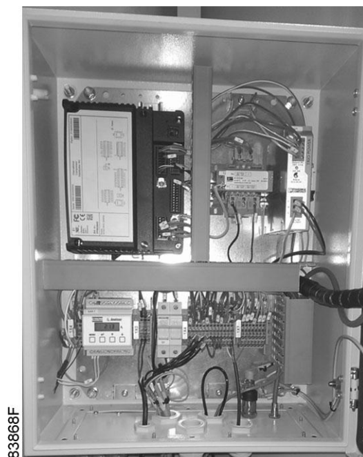
Внутри шкафа управления
